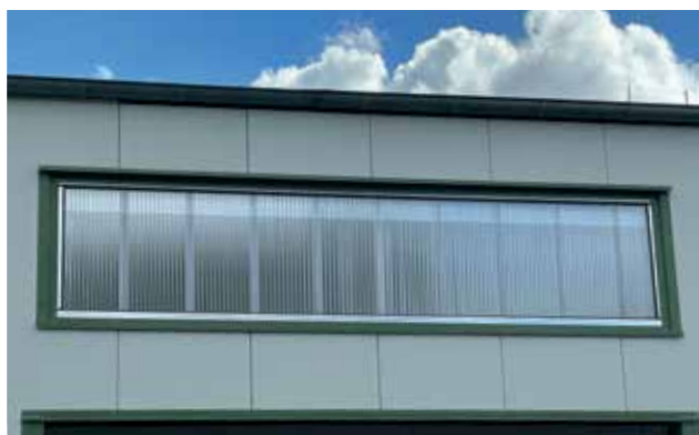
Aurora Set basic plus – eingesetzt in einer Industriehalle
