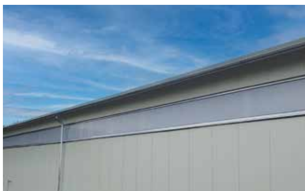
Aurora Set basic plus – eingesetzt in einer Lagerhalle
